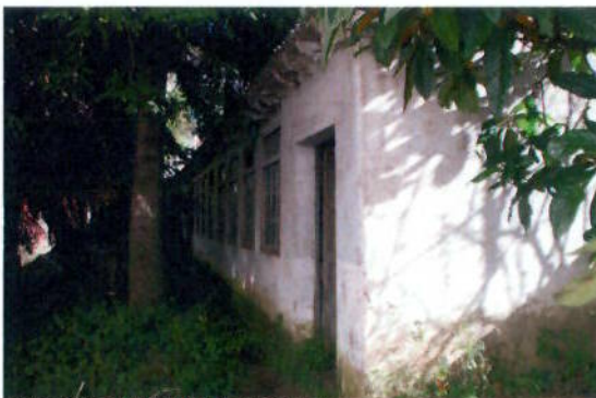
EXTERIORS NAU LATERAL AFECTADA
