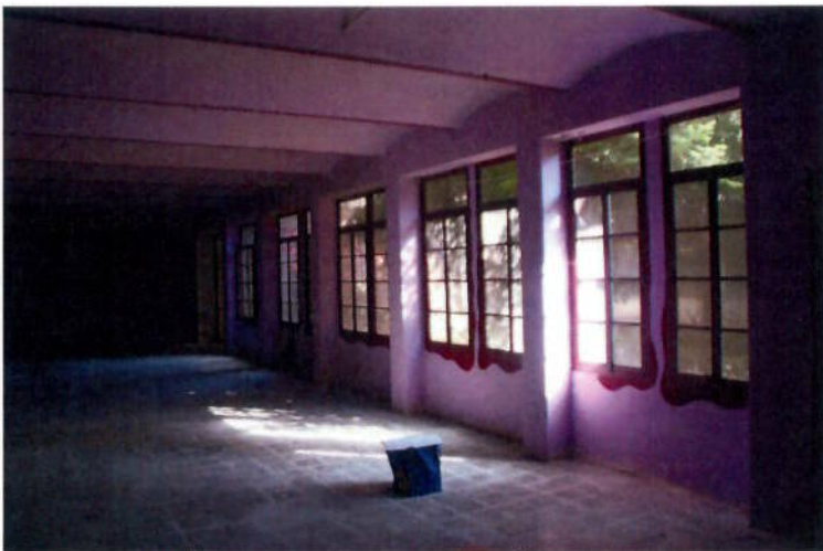
NAU AFECTADA EN L'ÚLTIMA CRUGIA ADOSSADA A L'ESGLÉSIA
