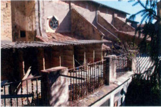
COBERTA NAU AFECTADA ADOSSADA A L'ESGLÉSIA
