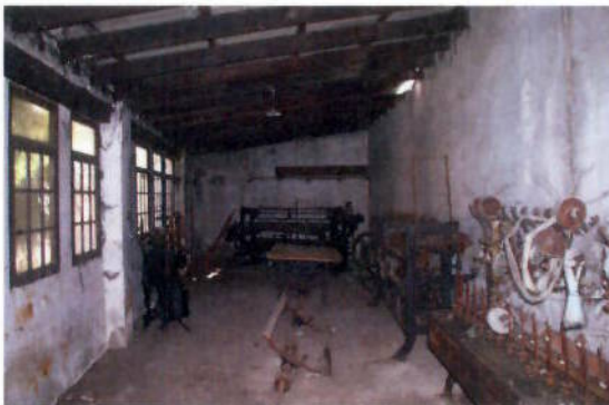
INTERIORS NAU LATERAL AFECTADA
